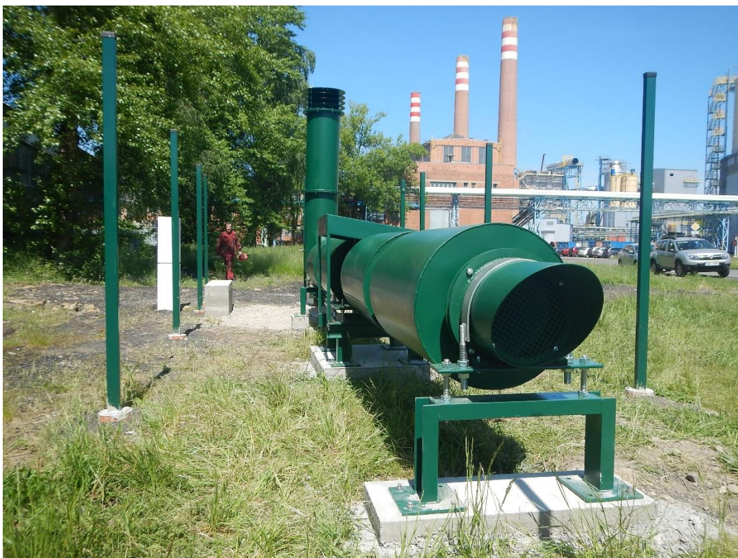
Instalace AOS v elektrárně Třebovice
